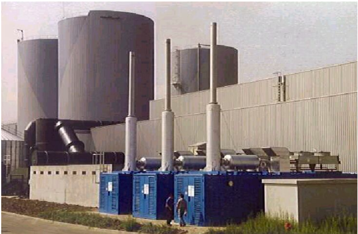
Abb. 9: Kommunale Biogasanlage Varennes-Jarcy, F
