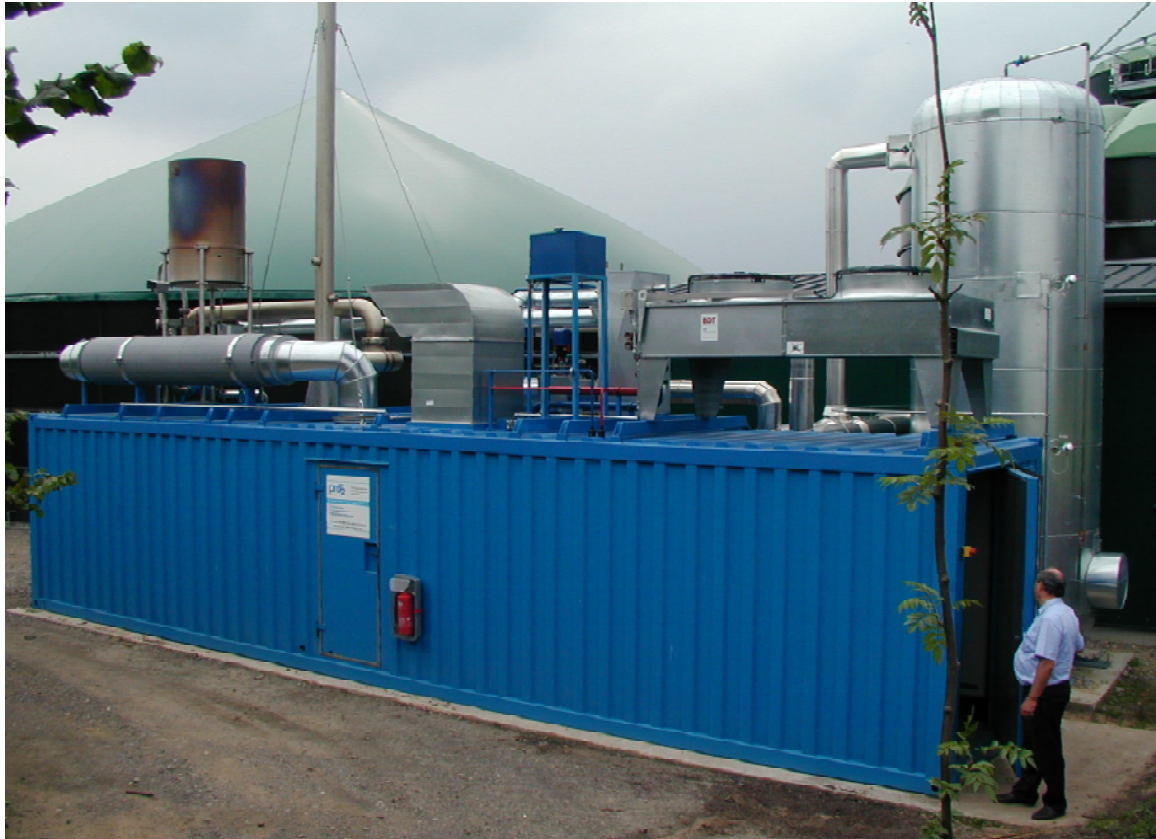
Abb. 8: Container-BHKW mit integrierter Gasaufbereitung und Notfackel
